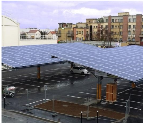
Photovoltaïque et ombrières de parking
